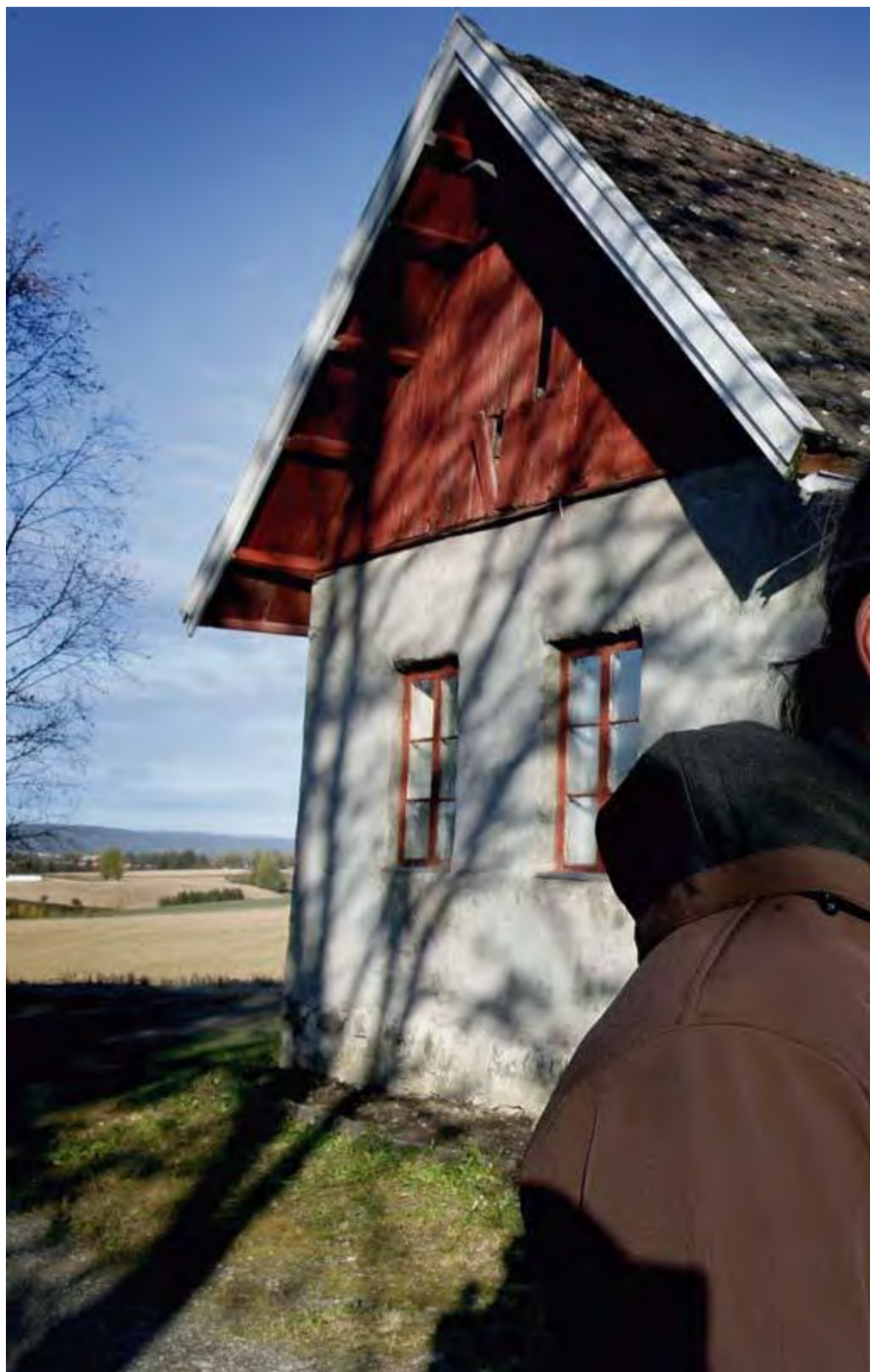
TRYGGES MED HJELP FRA KOMMUNEN | Kulturminnekonsulent Ola H. Fjeldheim hjelper Elisabeth med opprinnelige bygget.
