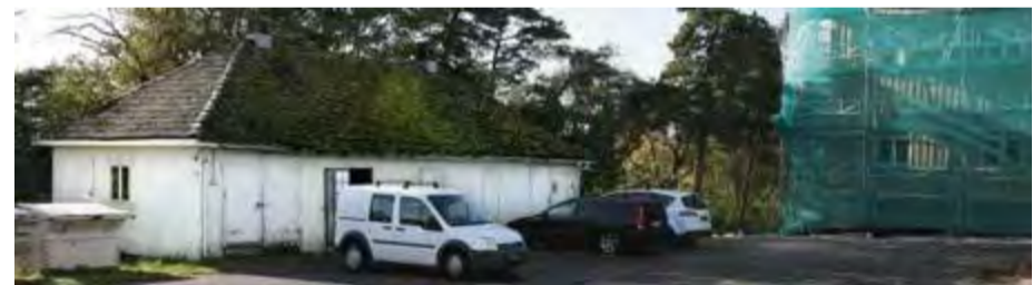
AUTENTISK | Uthuset er autentisk. Det vil si at det blant annet har originalt tak, vinduer og detaljering.
